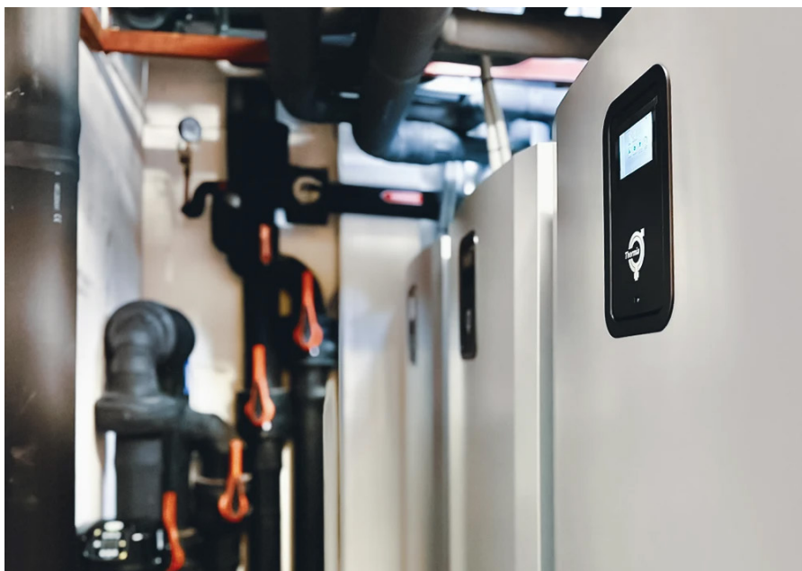
Tri tepelné čerpadlá Mega L v technickej miestnosti
